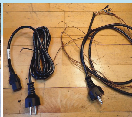
Komplett verschmorte Anschlusskabel (rechts) neben einem fabrikneuen Anschlusskabel (links).
